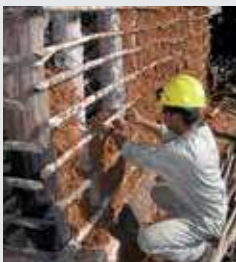
• Recuperación de técnicas constructivas tradicionales por parte de los alumnos de la Escuela Taller
