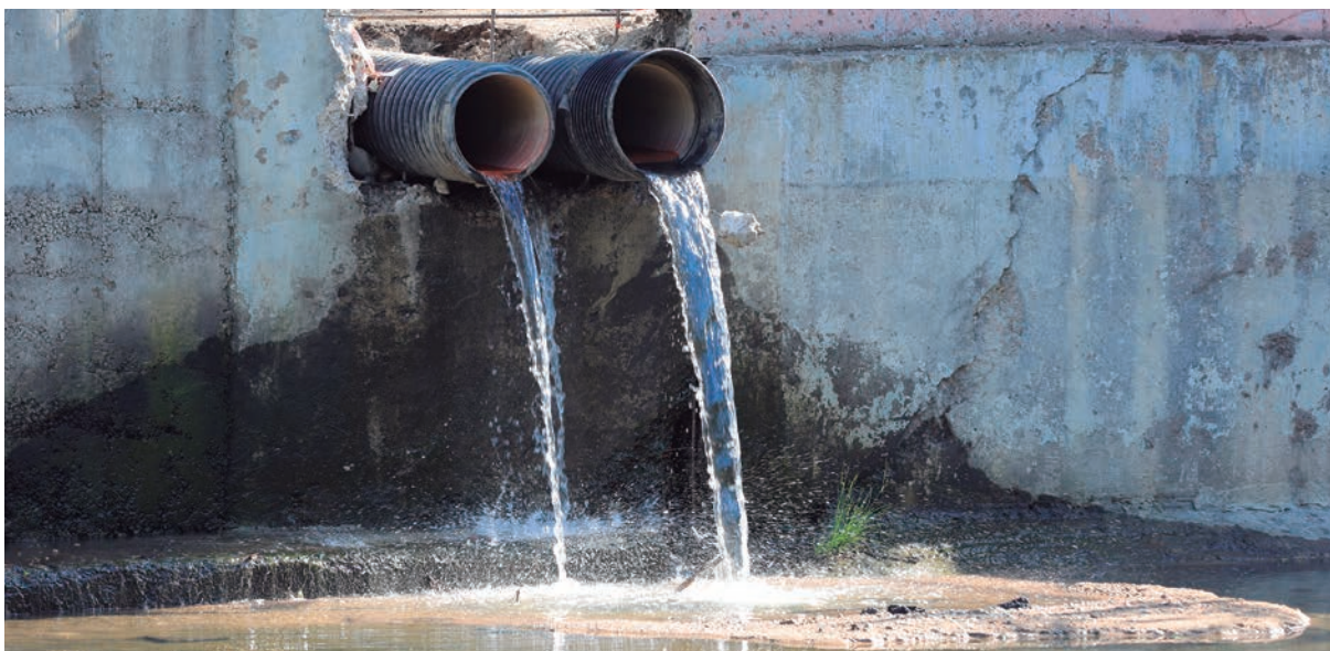
Vertido de aguas residuales
