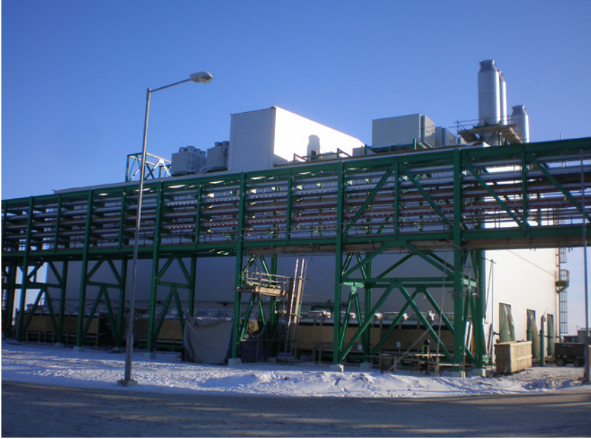
Ampliación de una planta de energía por IDOM.
