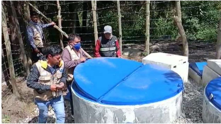
Figura 6. Planta de tratamiento agua potable Buenos Aires
