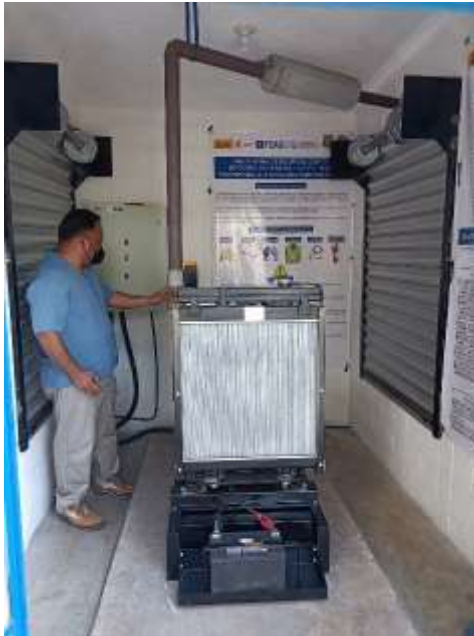
Figura 5. Estación de bombeo, Caserío Buenos Aires.
