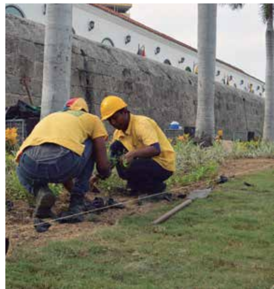
▲ Muralla de Cartagena. Taller de jardinería ◀ Convento de Santo Domingo. Taller de albañilería
