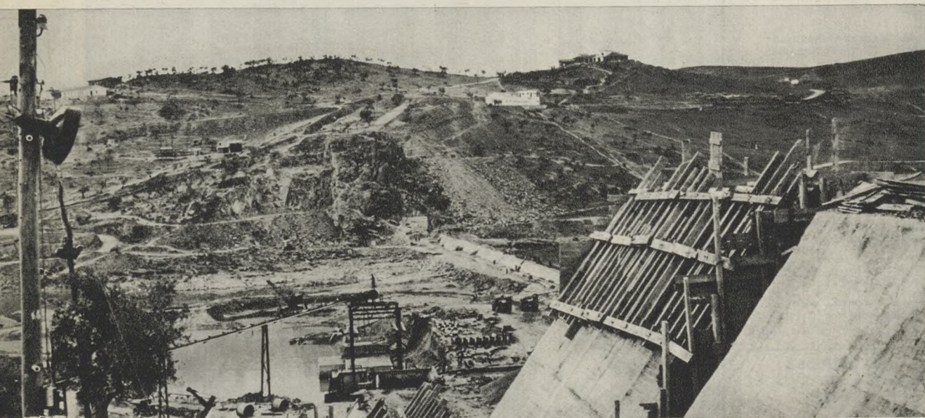
Presa de Orellana, también sobre el río Guadiana, y otra de las fundamentales del sistema, que, aparte de permitir embalsar 725.000.000 de metros cúbicos, regulando el río, es también presa de derivación. De ella parte el canal de Orellana, que tendrá 115 kilómetros de longitud y regará 52.500 hectáreas.
