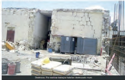
Daños. Habrían derruido muro y piletta para construir centro comercial. Fiscal constató trabajos para un sótano
