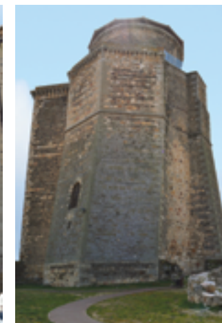
Alba de Tormeso kunigaikščių pilies donžonas, kurio sienos suaižėjo nuo baisiojo 1755 m. žemės drebėjimo Lisabonoje, esančioje už pusės tūkstančio kilometrų
