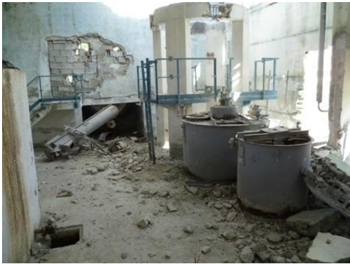
Fotografía 3: Demoliciones en las futuras salas de reactivos de la PTAP de Jatibonico.
