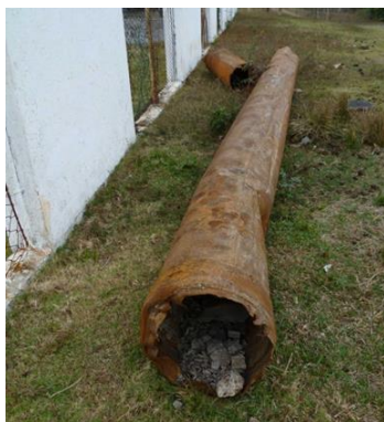
Fotografía 1: Estado actual de tramos de la tubería en alta del abastecimiento de La Palma
