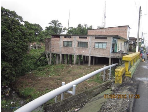
Fotografía 1. Tubería de petróleo bajo las casas
