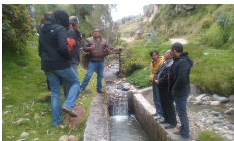
Fotografía 1: Captación principal de Acobamba
