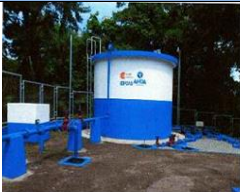
Fotografía 1: Tanque de recolección y red de distribución en Proyecto de Introducción del Sistema de distribución de agua potable y saneamiento básico a Cantón Cabos Negros, Mejoramiento de sistemas de saneamiento básico a cantones.
