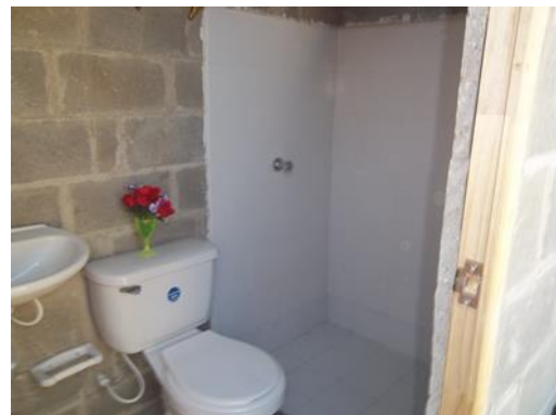
Fotografía 4: Modelo de baño construido por el programa para los beneficiarios de las Conexiones intradomiciliarias
