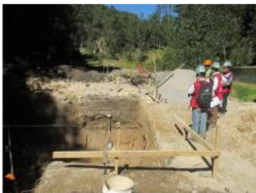
Fotografía 1: Excavación del predio para construcción del tanque de succión. Paraje Cruz Be. (Noviembre 2014)
