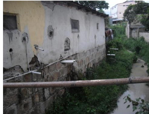
Fotografía 2: Descarga actual de aguas negras en el casco histórico de Santa Rosa, directamente a la quebrada.
