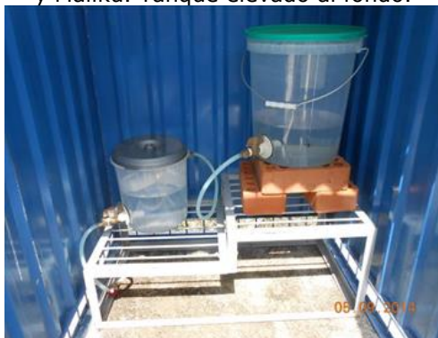
Fotografía 3: Dosificador de cloro desinfectante en el tanque de Puka Mayu, Cochabamba.
