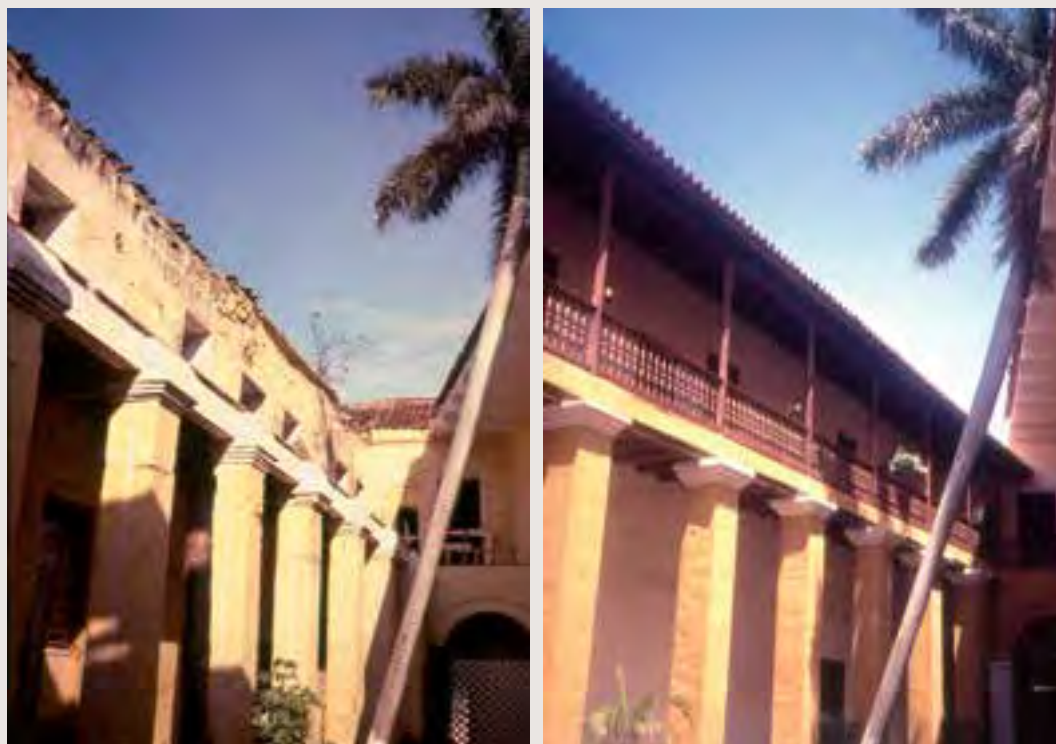
Patio anterior del antiguo Colegio de la Compañía de Jesús, antes y después de la restauración.
