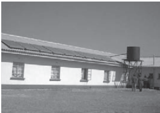
IMAGEN 1. SISTEMA DE TERMOSIFÓN DE PRODUCCIÓN LOCAL PARA UN INTERNADO, ZIMBABUE.
