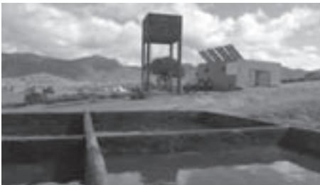
IMAGEN 4. SISTEMA DE ÓSMOSIS INVERSA FOTVOLTAICA INSTALADO EN TANGARFA (MARRUECOS). FUENTE: ITC.
