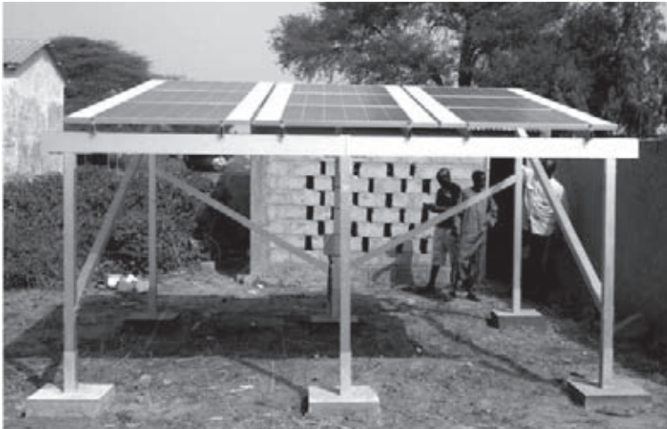
IMAGEN 4. INSTALACIÓN FOTOVOLTAICA Y CUARTO TÉCNICO. ALDEA DE FOURDOU (FOTO EXTRAÍDA DEL INFORME DE LA ASER).
