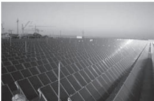
IMAGEN 2. VISTA DEL CAMPO DE COLECTORES SOLARES TÉRMICOS DE 36.305 M 2 INSTALADOS EN EL TEJADO DE UN ENORME ALMACÉN. FUENTE DE LA FOTO: MILLENNIUM ENERGY INDUSTRIES
