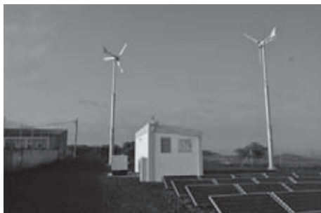
IMAGEN 5. VISTA PARCIAL DE LA CENTRAL DE LA MICRORRED DE VALE DA CUSTA. FUENTE: RICAM.
