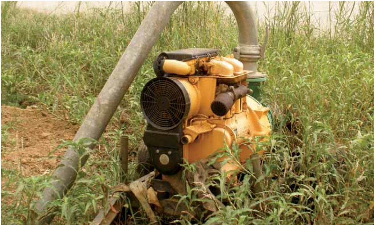
Photo 28. Motopompe de la Coopérative des Frères Diallo. Ville de Kayes, Kayes.
