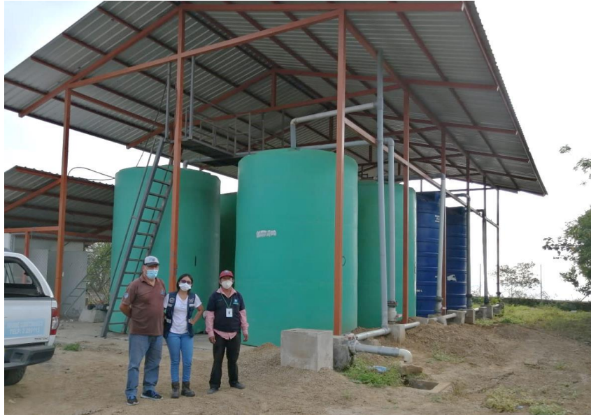
Tanques de almacenamiento en Manglaralto. Presentación de Paul C. Carrión
