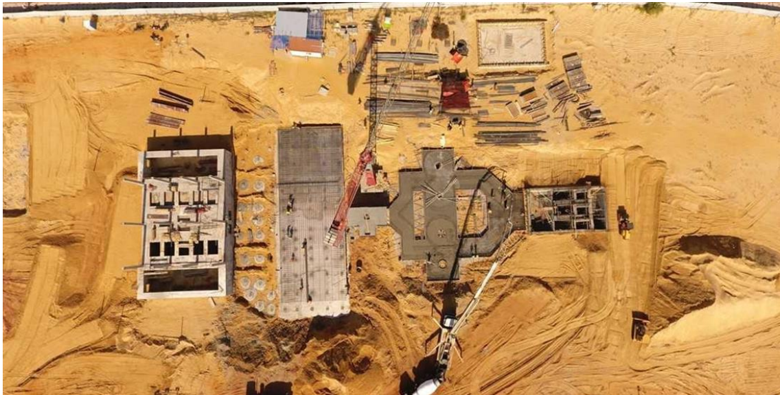
Planta de tratamiento de aguas residuales en Paraguay. Fuente: fcas paraguay
