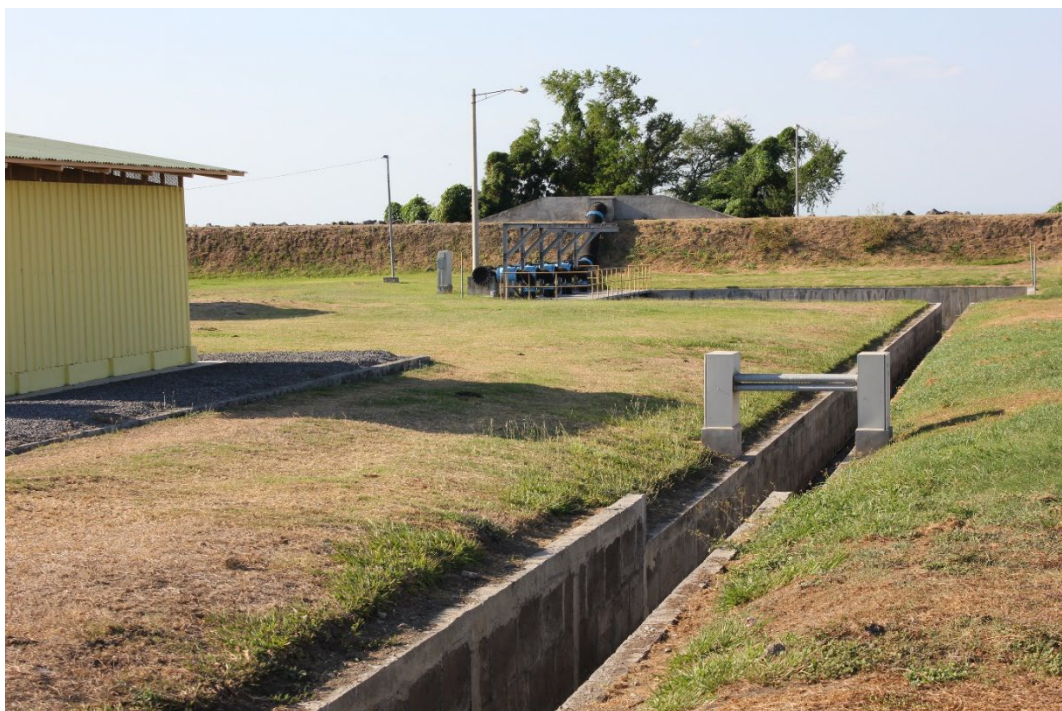
Figura 27 Dique de protección e instalaciones de drenaje en la PTAR de Managua (Nicaragua).
