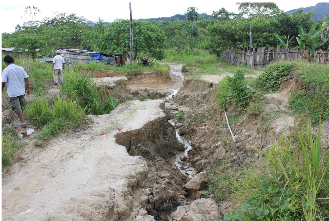
Figura 30 Deterioro por las lluvias del camino de acceso a uno de los terrenos estudiados para la PTAR de Yucumo (Bolivia).
