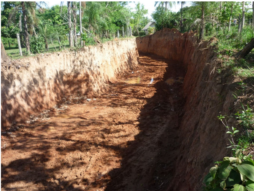
Figura 29 Obras de construcción del emisario a la PTAR de San Carlos, Bolivia.
