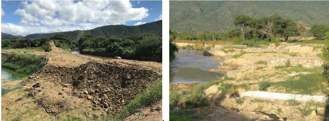
Figura 28. Derrumbe de un dique de la laguna de la PTAR de los Negros (Bolivia) debido a la socavación generada por el río y diques de protección construidos a posteriori para evitar el problema.
