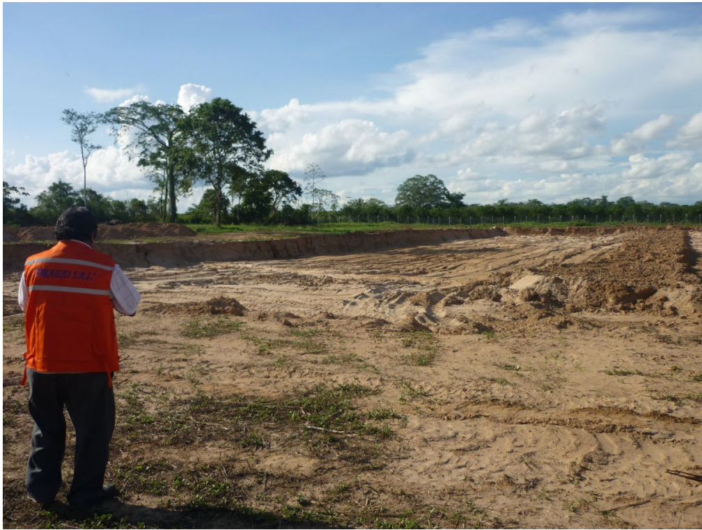
Figura 19 Movimiento de tierras en la construcción de las lagunas de Santa Fe (Bolivia).
