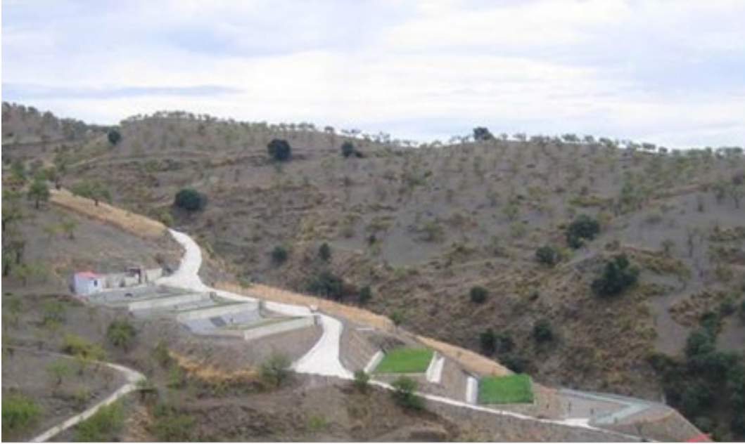
Figura 12 PTAR con Humedales de Flujo Vertical de Albondón (Granada, España). Fuente: CEDEX and CENTA (2010).
