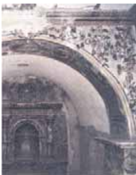
Pintura mural antes de la intervención
