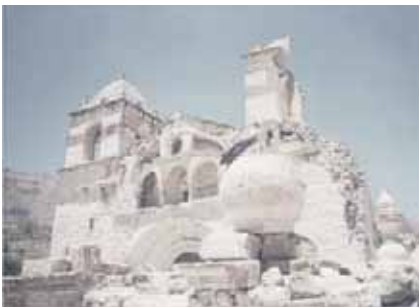
Estado del templo tras el terremoto de 1991
