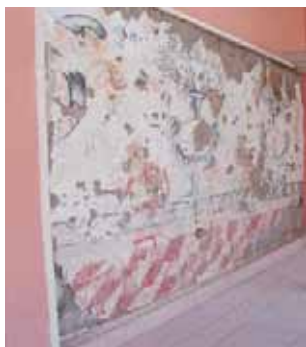
Pintura mural antes de la intervención
