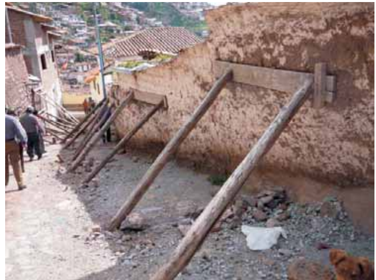
Muro en situación de riesgo en la calle Concepción
