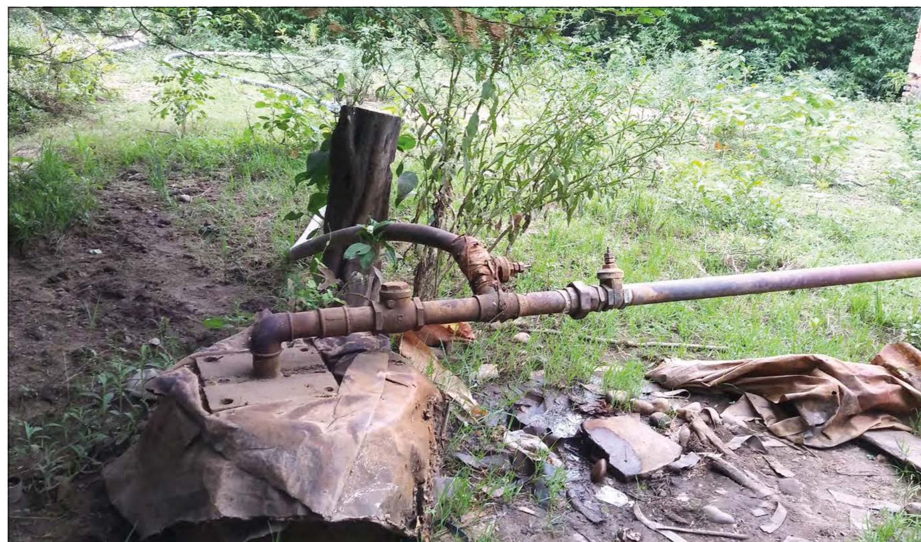
Foto 1: Situación de muchas de las perforaciones existentes. Fuente: foto de autor.
