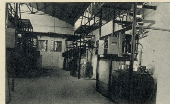
Una de las baterías de transformadores.
