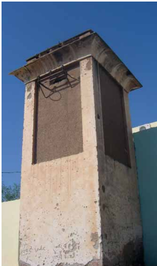
Torre de comunicaciones.
