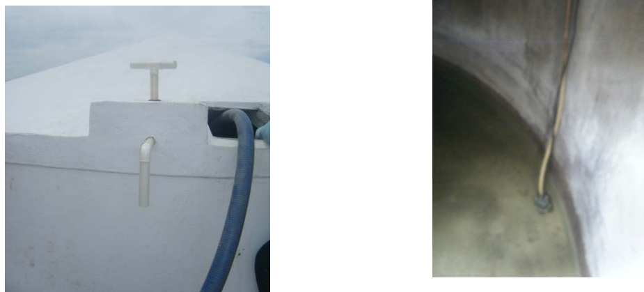
Figura 14. Fotos: (a)- Bomba Carcará II con tubo de PVC añadido y (b)- Bomba eléctrica instalada en el interior de la cisterna.
