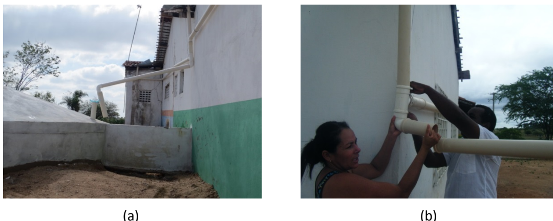
Figura 19. Fotos de escuelas donde se retiraron las primeras aguas de lluvia manualmente: (a)- Lagoa dos Cágados (Major Isidoro) y (b)- Cova do Casado (Canapí).
