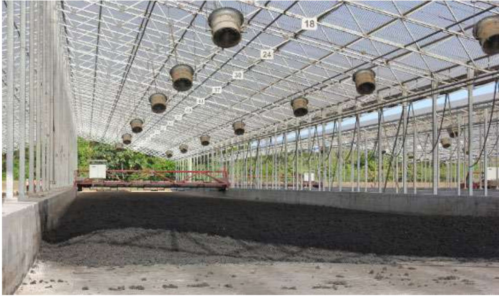
Figura II.4. Secado solar de lodos en la PTAR de Managua, Nicaragua
