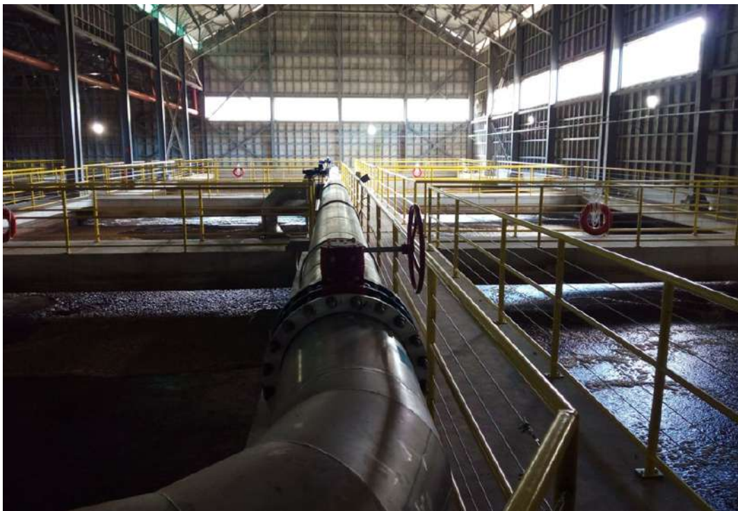
Figura II.2. Planta de tratamiento de Campos do Jordão con sistema MBR, Sao Paulo, Brasil
