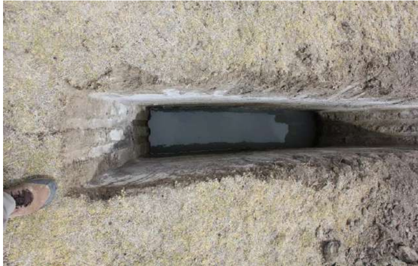
Figura 1.4. Catas para determinar el nivel freático en el terreno de la planta de Konani en Bolivia
