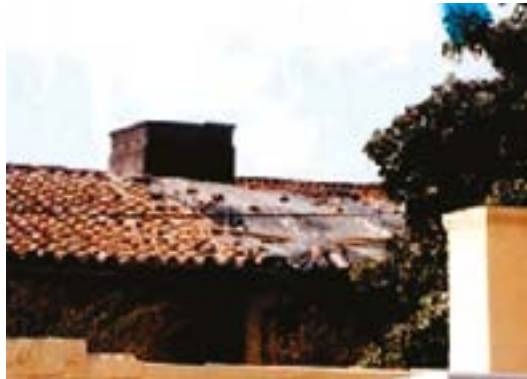
Casa Castelví. Estado previo Trabajos en la cubierta Trabajos en galería de ingreso
