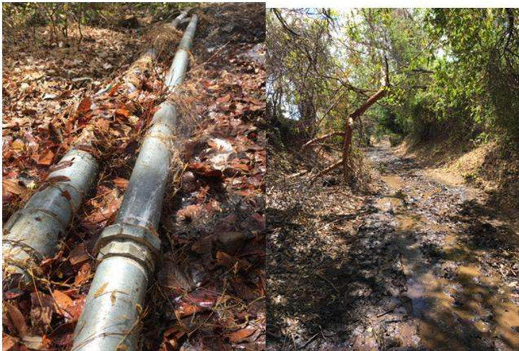
Fugas en la línea de impelencia del sistema Nanzal
