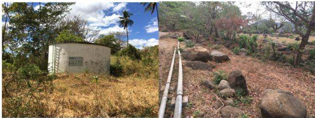
Tanque sistema anterior, nuevas y antiguas tuberías en paralelo comunidad El Nanzal
