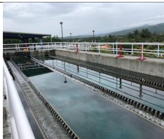
Sedimentadores de la planta
