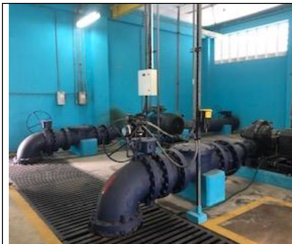
Cuarto de bombas Planta de Potabilización
