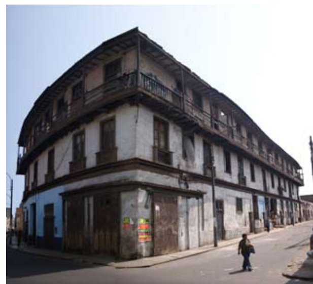
Arquitectura característica del Centro Histórico Estado deterioro de la Casa Buque en Barrios Altos
