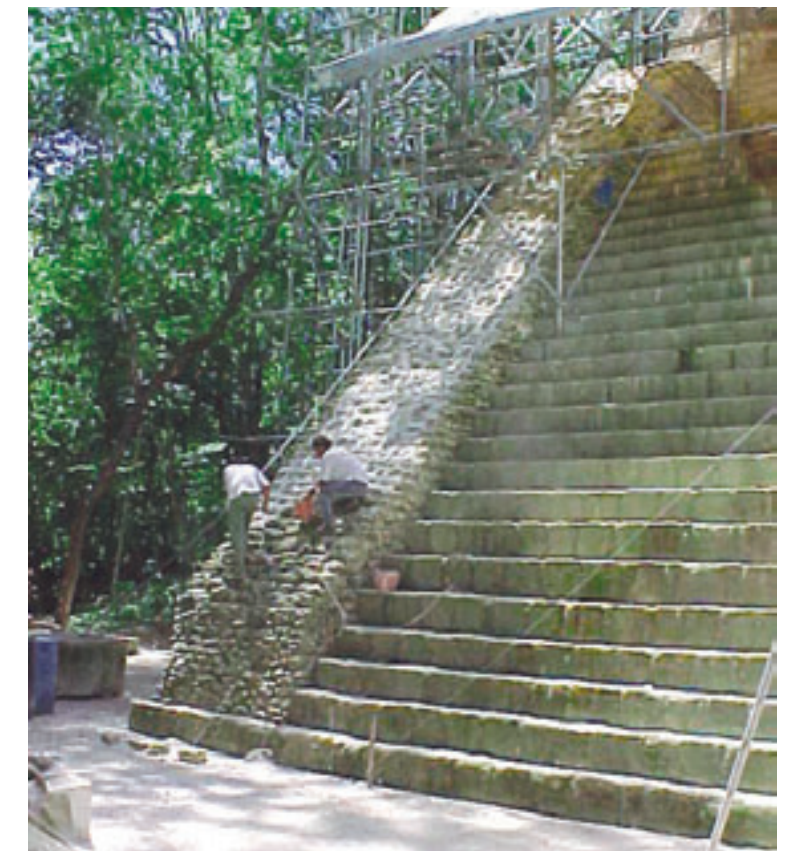
Vista parcial de la alfarda Este de la escalinata ceremonial del Templo V. Fotos. Arq. Rafael Chang 2000.
