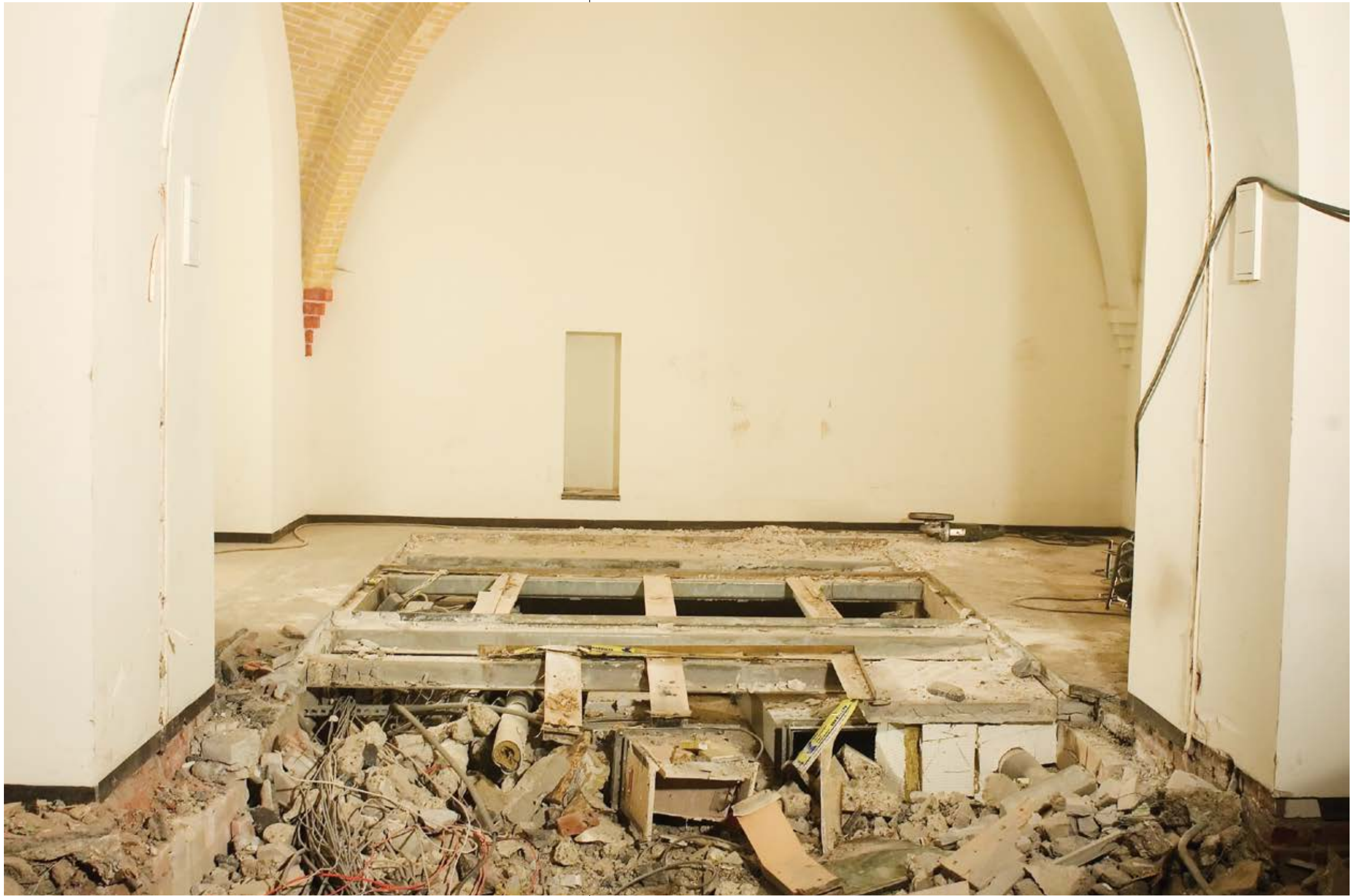
Levantando el suelo de la habitación D4 / Stripping the floor of Room D4 / Rijksmuseum, Ámsterdam, 2005
