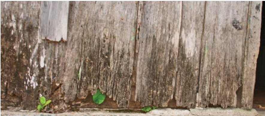
Podredumbre en paredes
