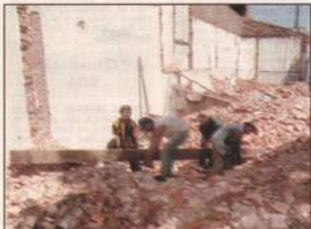
Escombros e intenso trabajo en el lugar donde se levantará la futura gran Biblioteca del Centro “Juan de Salazar”.
