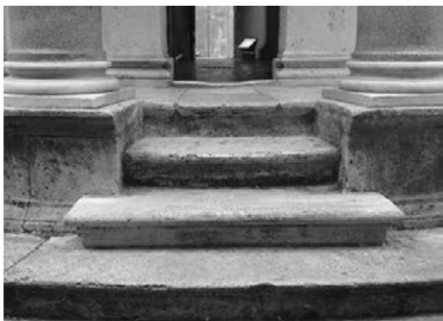
Fig. 20. Tempietto, lo stilobate in corrispondenza dell'ingresso principale est: a sinistra, veduta generale; a destra, particolare della cornice dello stilobate (foto F. Cantatore)
