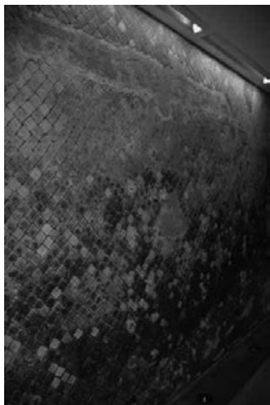
Fig. 9. Convento di San Pietro in Montorio, muro in opera reticolata (foto G. Schingo)
