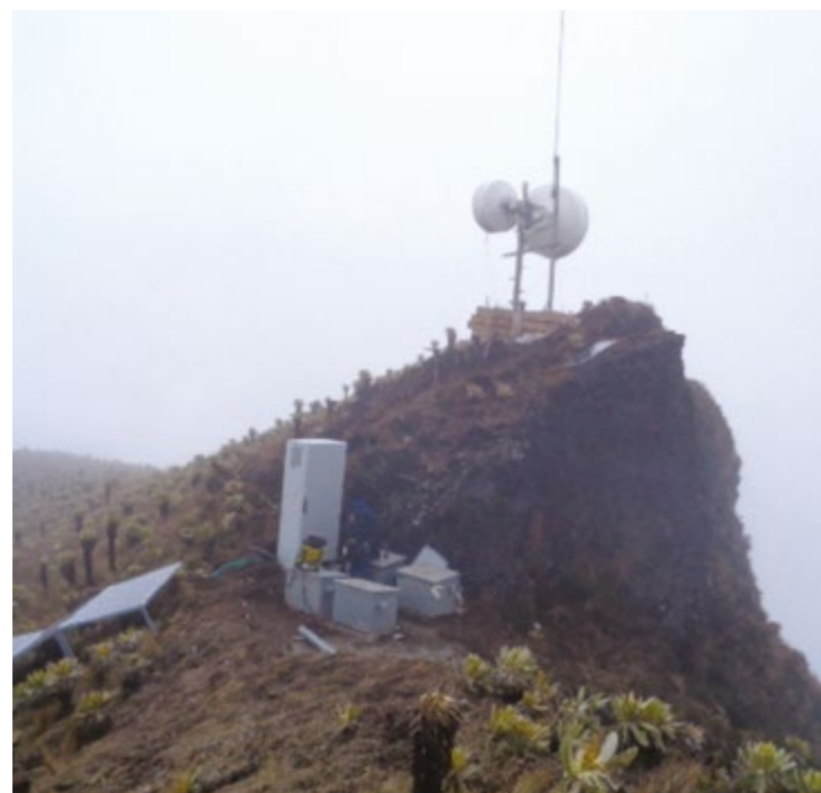
Figura 2. Estación Cerro Negro (frontera Ecuador- Colombia), repetidora de microonda.
