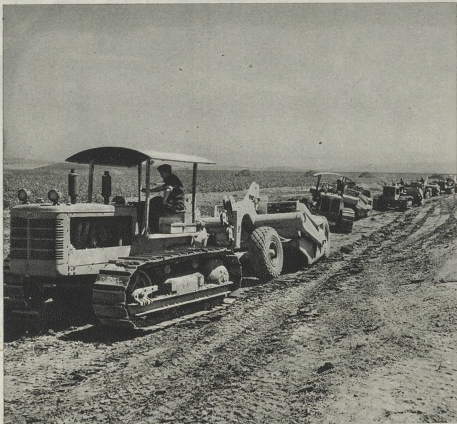
EL PREVIO ACONDICIONAMIENTO Y POSTERIOR NIVELACIÓN DE LAS TIERRAS EN LAS grandes superficies que transforma en riego el Instituto Nacional de Colonización son una de las obras fundamentales. Cuenta el Instituto con modernos y potentes equipos mecánicos, en los que se han invertido 465 millones de pesetas, y tiene pendientes de recibir otros por un importe aproximado de 364 millones.
