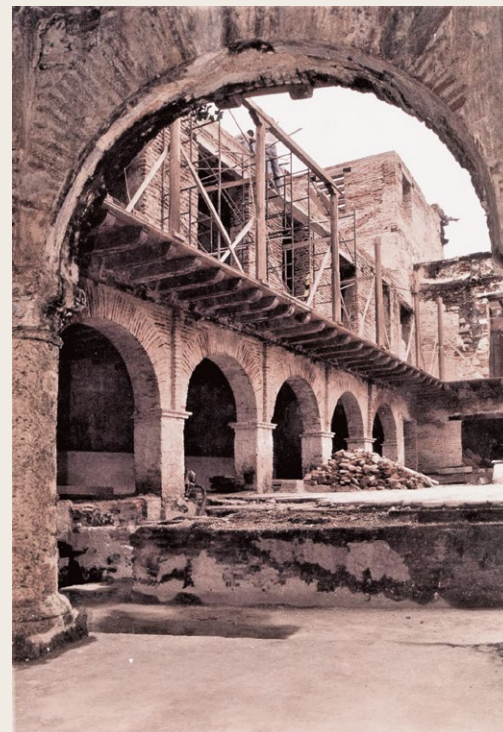
▲ El patio desde el zaguán durante el proceso de restauración. Fotografía: LVC
