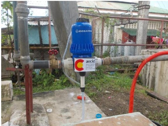
Dosificadora de cloro y depósito de gravedad.
